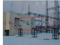
Electric substation (Kami, Miyagi)
